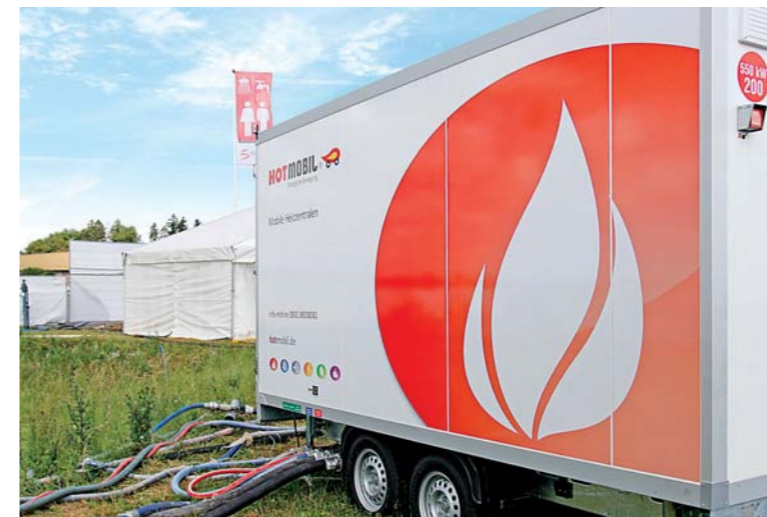
Die Hotmobil Heizzentrale ist unverzichtbarer Bestandteil der eps Sanitär-camps. Sie sorgen für die Bereitstellung von Warmwasser.
